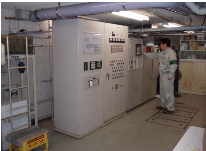
内部では24時間排水に異常がないか監視を行っています。
