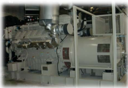
自家発電設備
