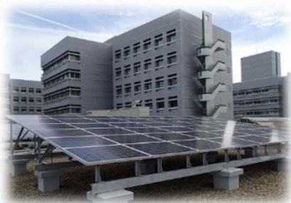
太陽光発電設備
