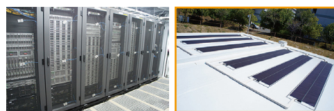
コンテナ内サーバ群
