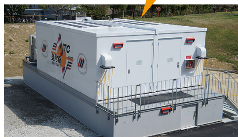
コンテナ型データセンター
